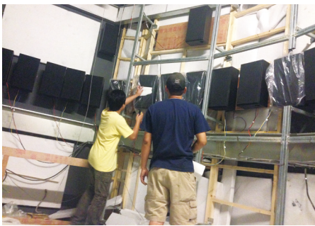
全息音频后期制作室：音箱“入墙式”安装
